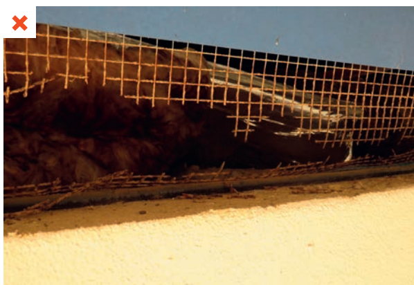
Grille de protection antinuissibles détériorée. ©AQC
