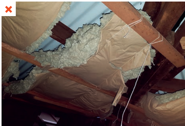
Des panneaux d'isolant souples ont été mis en œuvre pour l'isolation des rampants. Ils sont fortement dégradés et ne sont pas correctement maintenus. ©AQC
