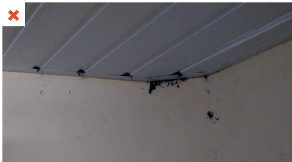
Déjections de chauve-souris venant du faux plafond. ©AQC
