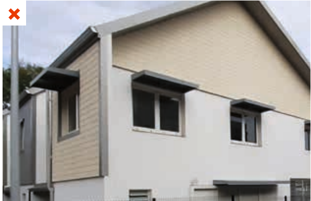
Dans ce petit immeuble collectif, les mêmes casquettes sont utilisées pour toutes les orientations, alors qu'elles sont peu efficaces sur cette grande façade nord-est. ©AQC
