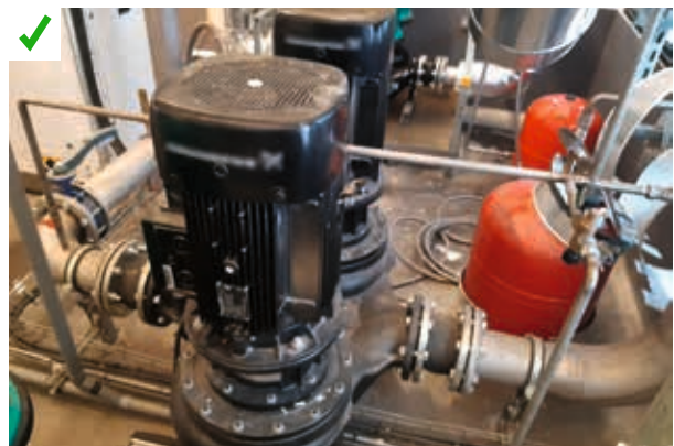
Pompes à débit variable. ©AQC
