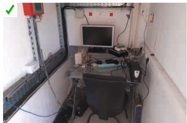
Plateforme de GTC/suivi des consommations. ©AQC
