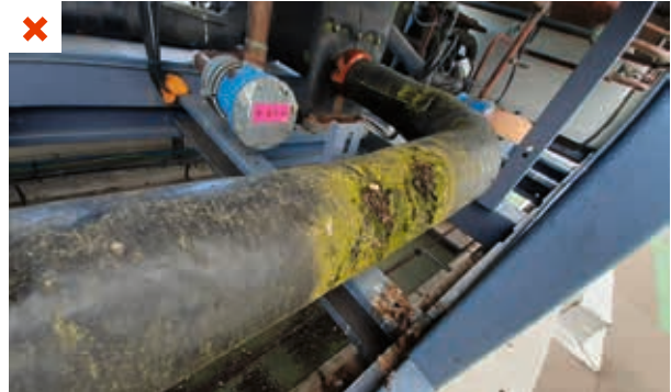
Développement de mousses suite à une maintenance incomplète. Aucun contrôle de la bonne réalisation de la maintenance n'a été effectué. ©AQC
