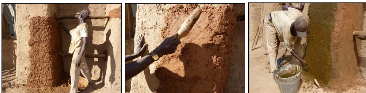
Mise en œuvre de l'enduit : pose, frappe et badigeon de bouse de vache. © Sébastien Moriset/CRAterre-ENSAG
